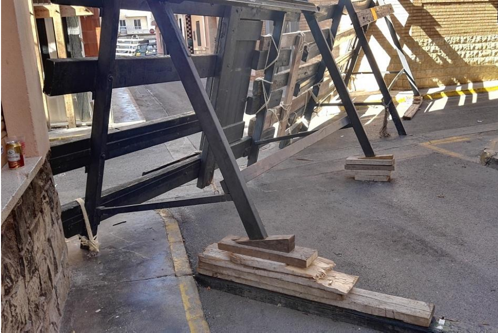
Fig nº 1: Apoyos deficientes en Barreras de Tijera.
