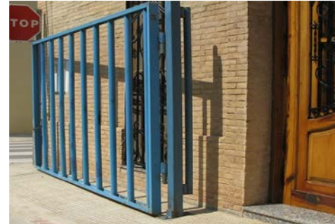
Hueco superior a 32 cm: Tubo soldado a montante.
