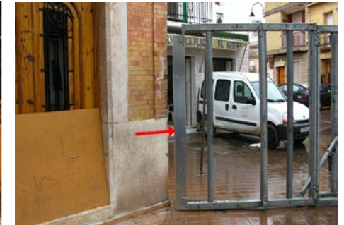
Hueco inferior a 28 cm: Chapa cerrando hueco.
