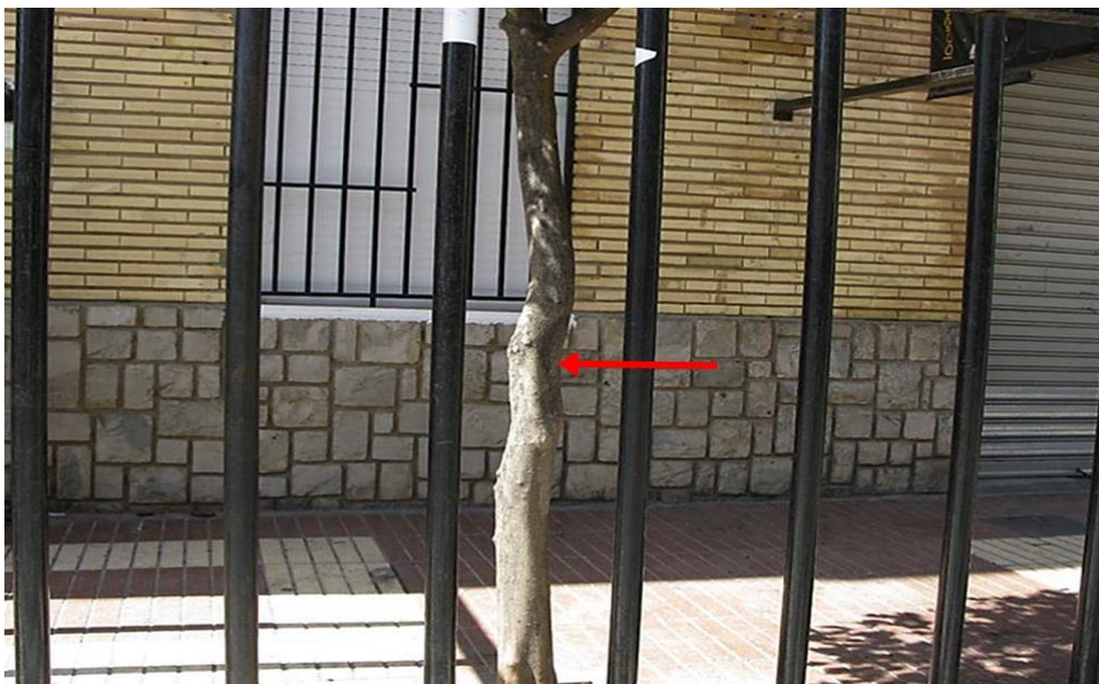
Tronco de árbol colindante a hueco en barrera vertical: Obstáculo en el paso entre barrotes.
